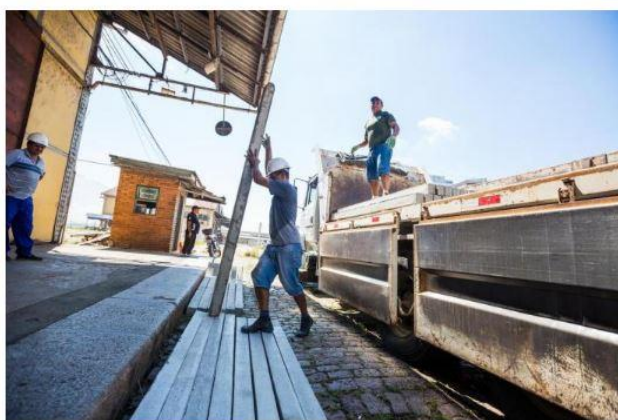
Operários começaram a descarregar materiais na via interna do cais, junto ao Muro da Mauá, no começo de março Omar Freitas / Agência RBS
